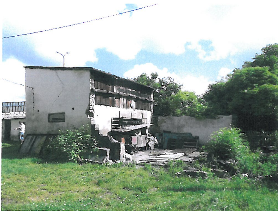
Budynek gospodarczy + gospodarczy – częściowo wyburzony (elewacja frontowa / tylna)
