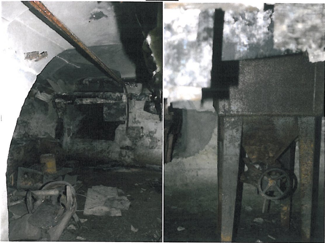
Piwnica – pomieszczenia kotłowni
