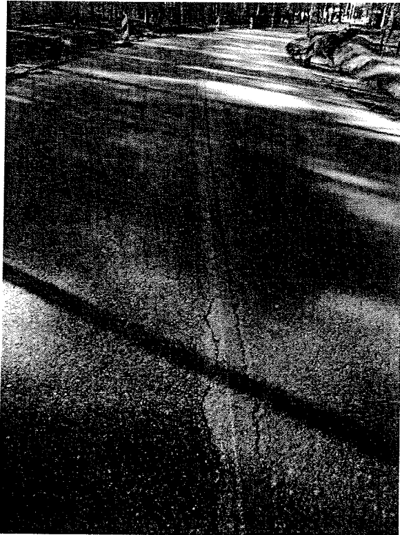
Fot. 2. Spękanie podłużne km 0+200
