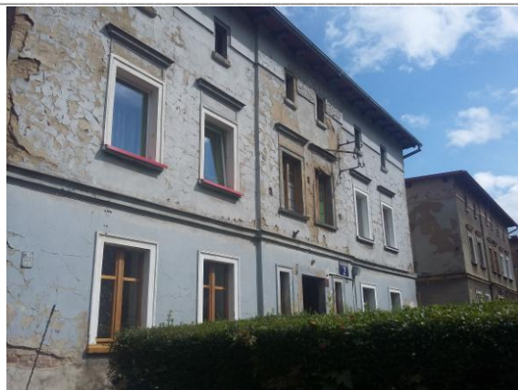
Rycina 35 Skontrolowany budynek przy Ul. Zachodnia 2 Wałbrzych.
