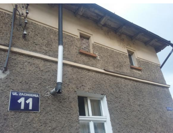
Rycina 39 Skontrolowany budynek przy ul. Zachodnia 11 Wałbrzych
