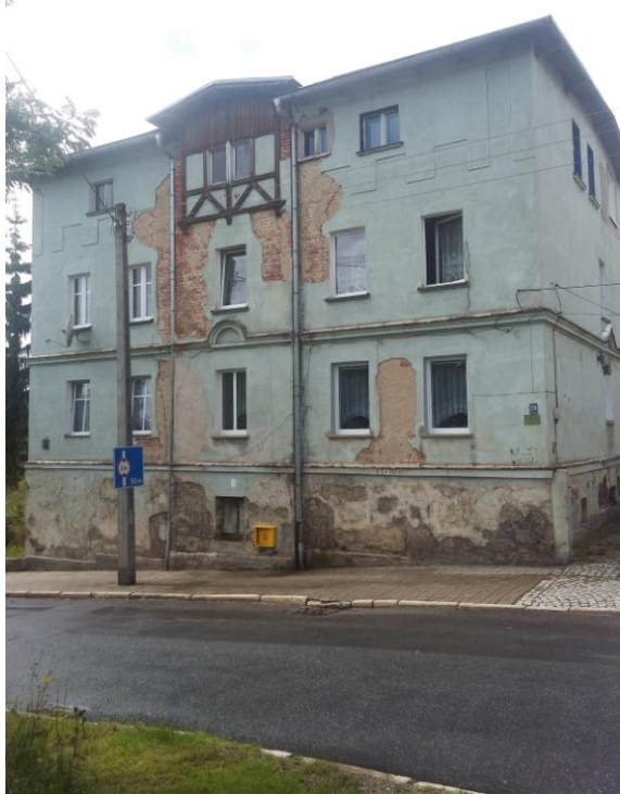
Rycina 32 Skontrolowany budynek przy Ul. Świerczewskiego 28 Boguszów Gorce
