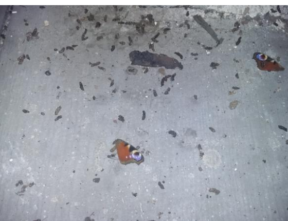
Rycina 37 Odchody mroczka późnego na strychu budynku przy ul. Zachodniej 1 w Wałbrzychu
