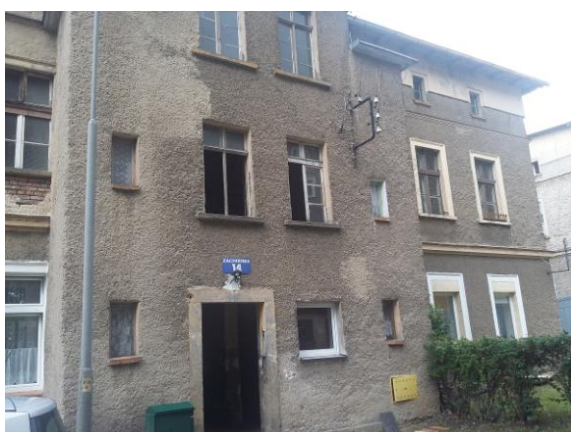
Rycina 38 Skontrolowany budynek przy ul. Zachodnia 14 Wałbrzych
